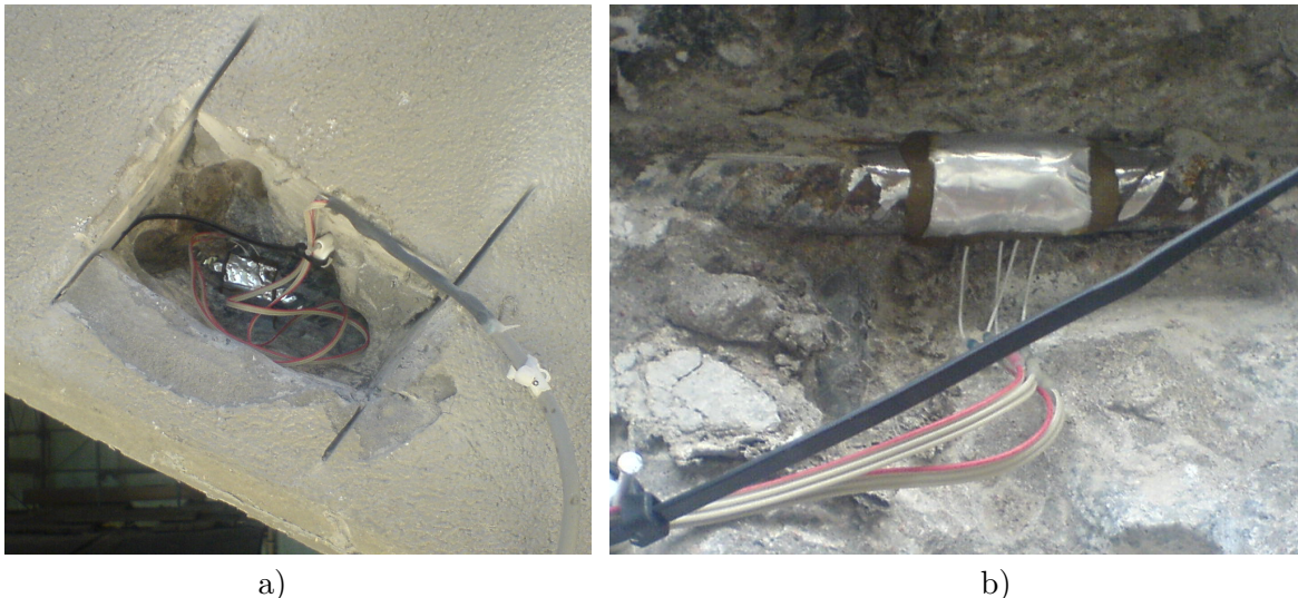
Figur 1.1: Instrumenterade givare, a) givare 14 i fjärdedelspunkten på den östra bågstrimlan, b) detalj av givare 16, i hjässan på den västra bågstrimlan.
