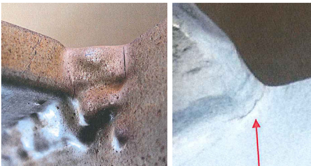
Figur 5: Påträffad utmattningsspricka i anslutning mellan tvärbalk och tvärplåt för vindförband, från (Ekelund, 2011).
